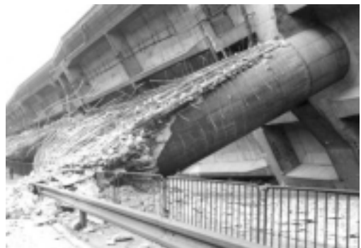
写真1 インフラストラクチャーの被害
